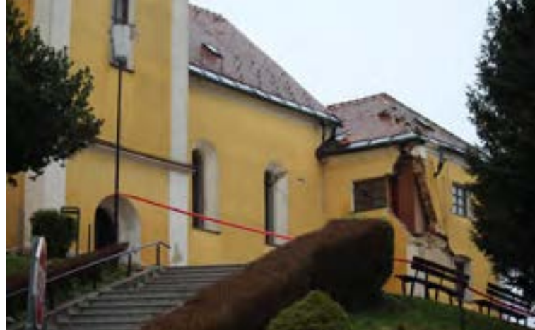
Eingestürzte Kirche im Erdbebengebiet
